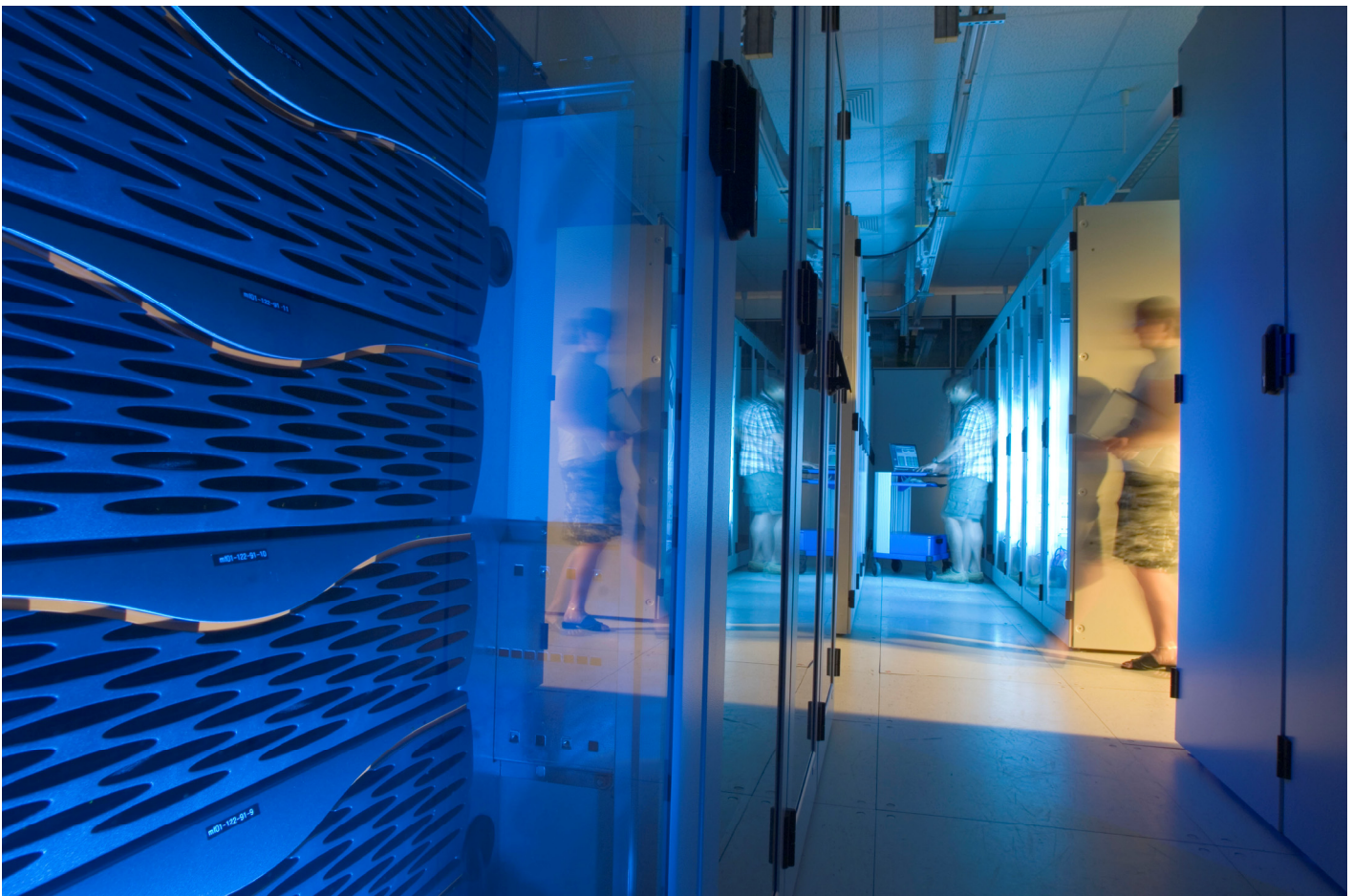
Das am SCC angesiedelte Grid Computing Centre Karlsruhe (GridKa) stellt als eines von elf weltweiten Tier-1-Zentren Rechenleistung und Speicherkapazität für die Teilchenbeschleuniger-Experimente am CERN zur Verfügung.
